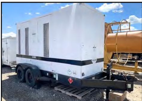
1993 Cat 3406 350 KW 480 volt 3 phase, 12,010 hrs
